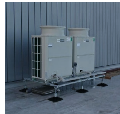
Bij schuine daken airconditioning uit het zicht en op bijgebouw of aan de achterzijde van het gebouw.
