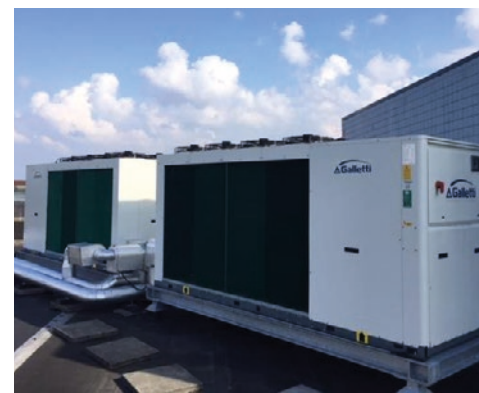
Warmtepomp op plat dak (groter volume).
