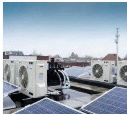
Airconditioning tussen of naast zonnepanelen
