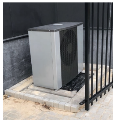
Warmtepomp voor schuin dak (look vanaf openbare weg niet zichtbaar).
