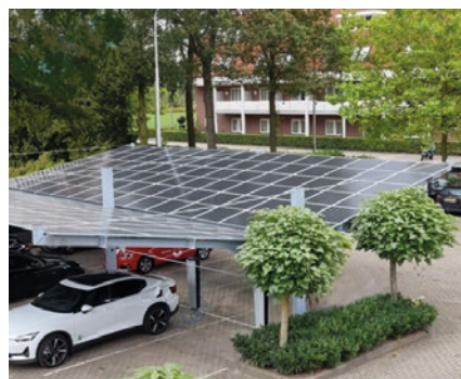
Zonnepanelen boven parkeerplaatsen mogelijk. Bij gebruik is een groene inrichting gewenst.
