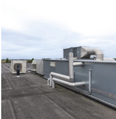
Luchtventilatiesystemen op het dak
